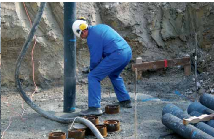
Přesah piloty se odřeže v požadované výšce a použije se jako první část další piloty
